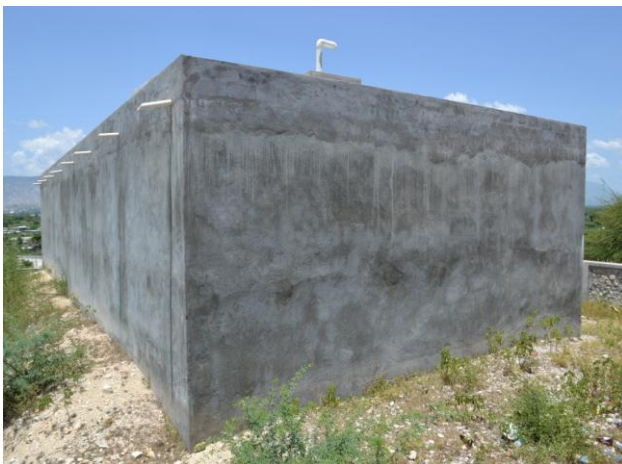
Vue de l'un des réservoirs des Gonaïves (960m3)
