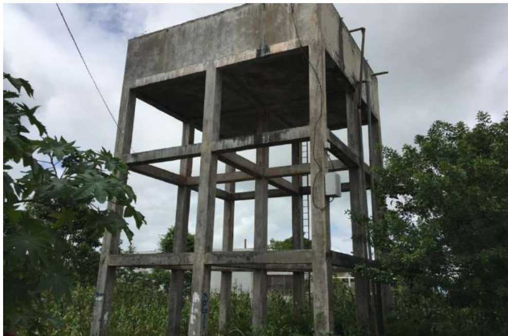
Figure 3: L'actuel réservoir de Redoré qui va être démolé et reconstruit est aussi très proche des bâtiments abritant des services (école, église, station de radio et des résidences privées). Si aucune mesure n'est prise, des risques pourraient être notés sur les riverains qui fréquentent la zone en termes d'accidents et autres nuisances. Les responsables de ces établissements doivent être informés avant les travaux, l'accès doit être garanti et signalé pour éviter les accidents.
